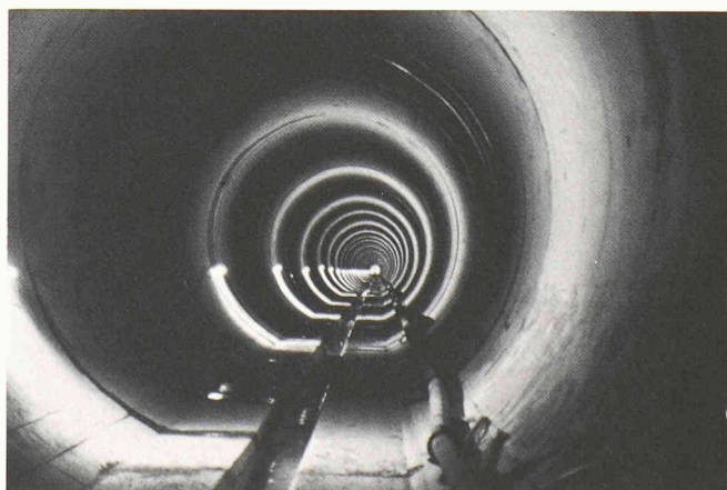
Lot 2. Galerie terminée, munie de son revêtement définitif. Ce lot, long de 4,4 km, a été entièrement excavé au tunnelier (Wirth, type TBS III 520 E, \phi de forage 5,20 m).
