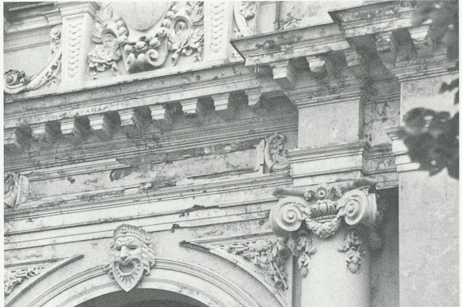
Effet de dégradation des détails décoratifs sur la façade au couchant.
