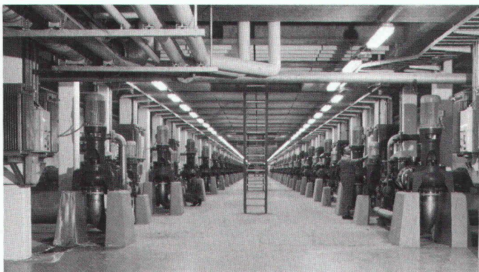
Installation d'épuration Lynetten, Copenhague, 115 pompes TURO.
