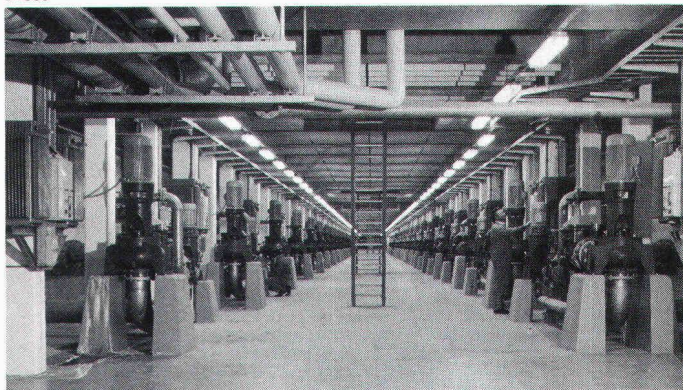
Installation d'épuration Lynetten, Copenhague, 115 pompes TURO.
