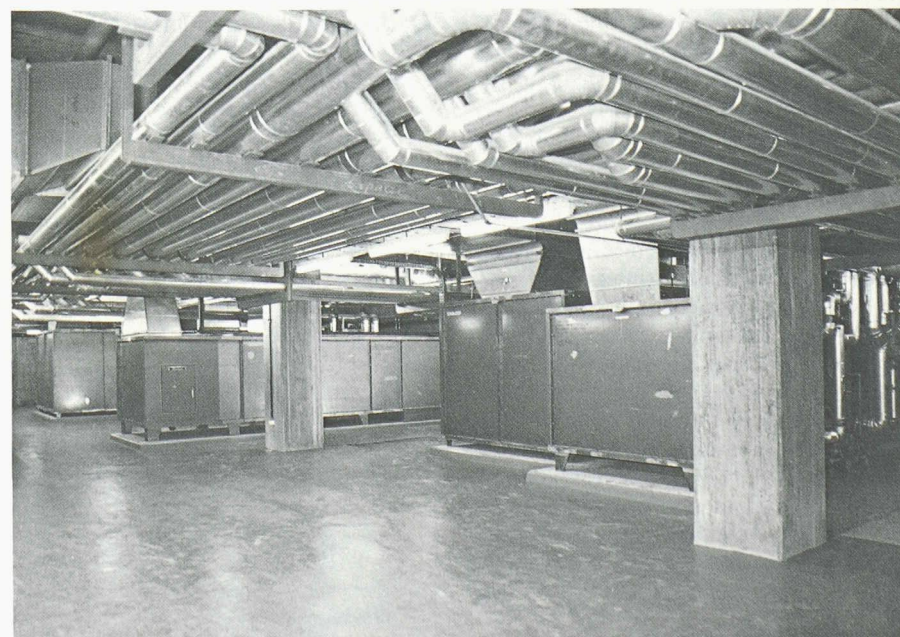
Fig. 3. — Vue des installations techniques.
