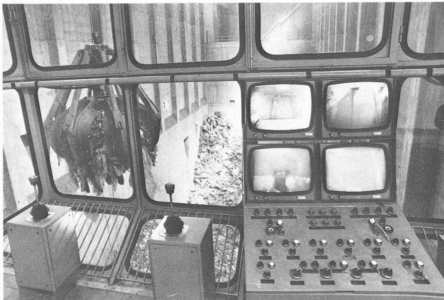
Fig. 3. — Les principales opérations de contrôle du fonctionnement de l'usine d'incinération de Monthey s'effectuent par un réseau de télévision interne.
