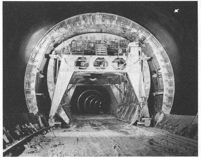
Fig. 6. — Lot est. Portique de cintrage pour le bétonnage de la voûte intérieure, après l'application de l'isolation élastique.
