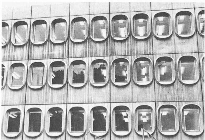
Fig. 14. — Exemple de façade sans étude d'écoulement de l'eau.
