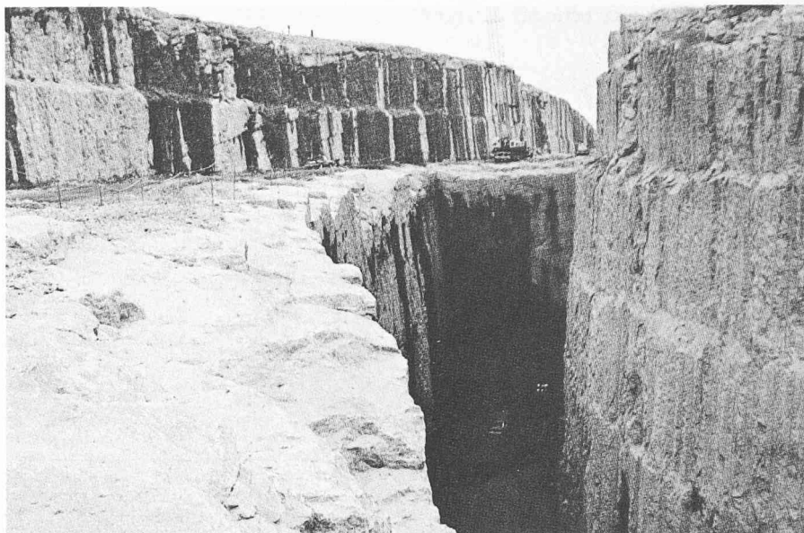
Fig. 23. — Photo des galeries superposées, dessus l'évacuateur des crues, dessous la galerie de dérivation.
