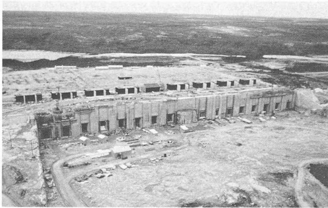
Fig. 10. — Photo des seize ouvertures de la prise d'eau de la centrale.
