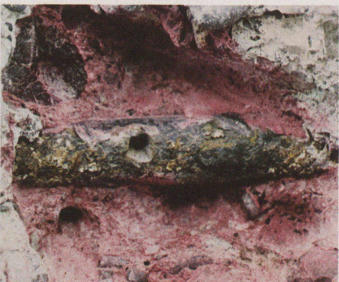
Pont C. — Le tiers inférieur de cet acier est atteint par la carbonatation et l'oxydation l'a déjà désolidarisé de sa couverture de béton.
