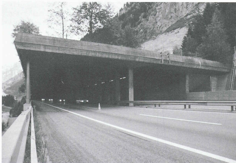
Fig. 1.- Galerie de protection contre les chutes de pierres de Gütli, portail Sud
