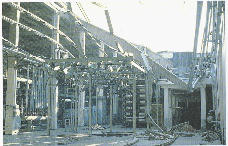
Fig. 7.- Portion effondrée du toit d'une usine, entraînant la destruction complète d'une chaîne de teinture de textile
