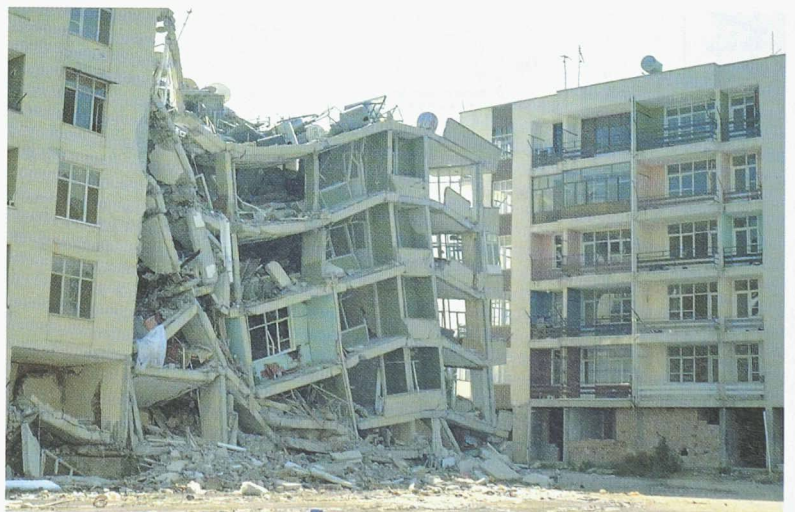
Fig. 4. – Deux immeubles d'habitation avec des structures porteuses semblables montrent un comportement totalement différent : l'immeuble de gauche est détruit (niveau de dégâts 5) tandis que l'immeuble de droite pourra être réparé (niveau de dégâts 3)
