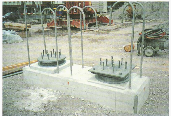
Pont de raccordement à la Voie-Centrale: socle avec appuis pots et barres servant d'encastrement provisoire
