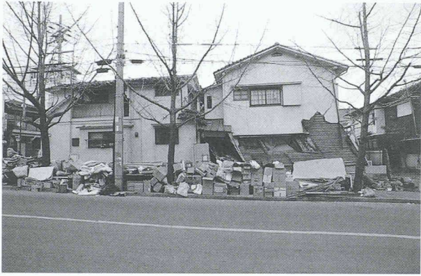
Fig. 14. – Maison en bois ayant basculé sur la gauche sous l'effet de soft-storey
