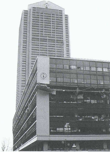
Fig. 15. – Bâtiment de l'administration communale avec un étage intermédiaire effondré
