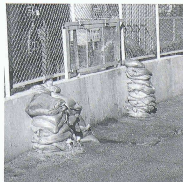
Fig. 7. – Sacs de sable utilisés pour colmater les fissures d'un bassin de rétention dans un parc de réservoirs
