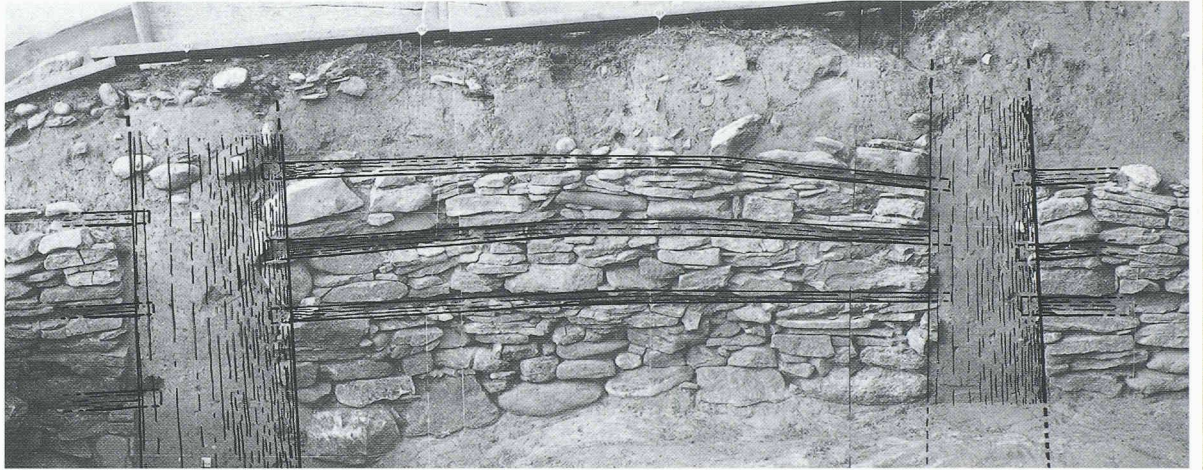
Fig. 5. – Vue du mur de refend nord de la tour sud (les fils sont distants de 1 m). Restitution graphique des éléments en bois
