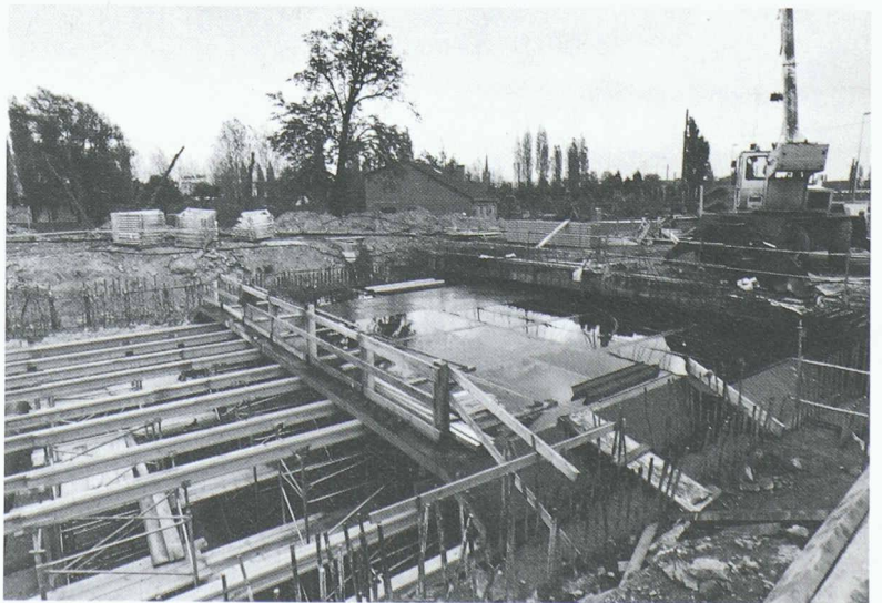
Fig. 9 et 10. – Travaux de bétonnage à l'aide de coffrages se déplaçant sur rails.
