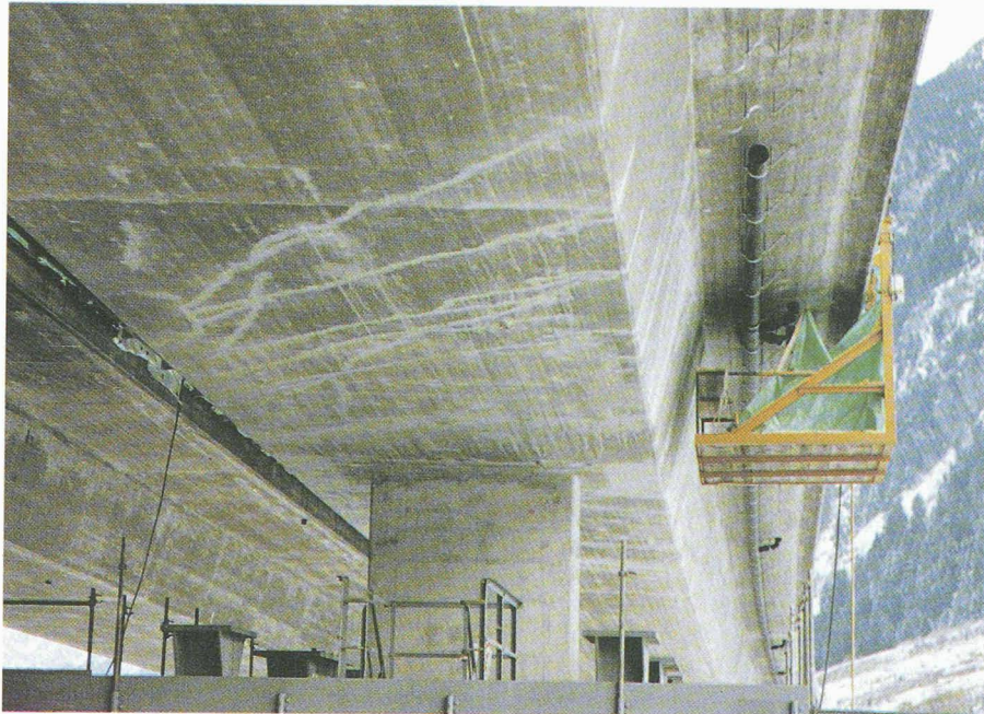
Fig. 19. – Conduite d'évacuation d'eau et fissures injectées dans la superstructure et la tête de pile. (Photo A. von Glutz.)
