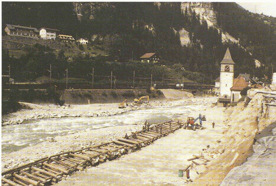
Fig. 4. – L'église de Gurtellen, au premier plan la route du Saint-Gothard détruite, construction de parois « Krainer ». (Photo Office des Travaux publics d'Uri.)
