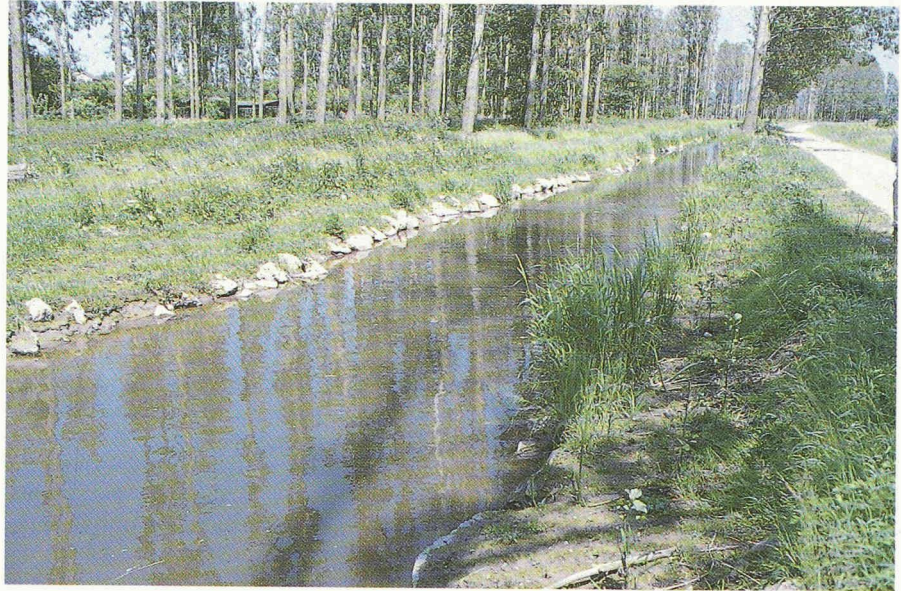
Wieseck. Le ruisseau de plaine régularisé et protégé par des empierrements dans la périphérie de Giessen.
