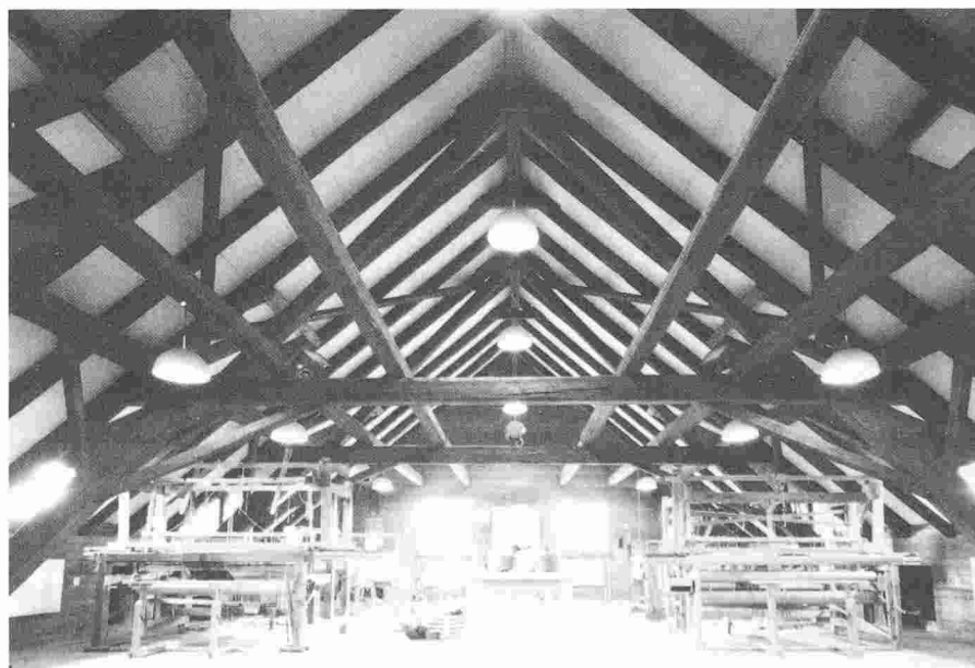
Ferme et grange transformées par l'architecte Werner Schmutz en un centre de loisirs du Spittelhof. Le système de sous-couverture SarnaRoof, grâce auquel les activités de loisirs peuvent se dérouler dans un climat ambiant agréable, a été réalisé sur la structure porteuse, qui est ainsi restée apparente.
