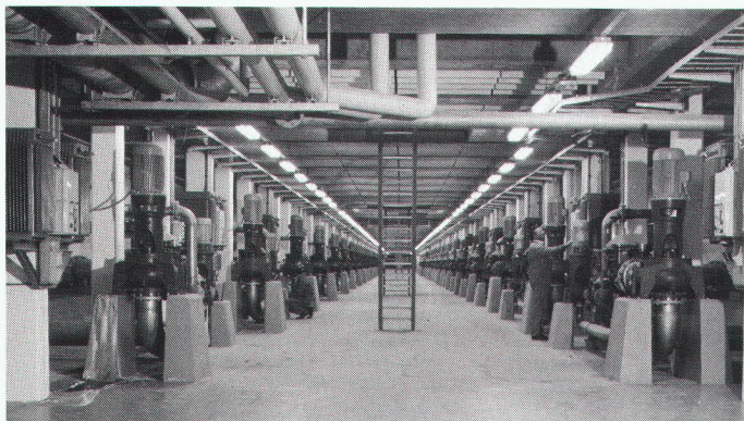
Installation d'épuration Lynetten, Copenhague, 115 pompes TURO.
