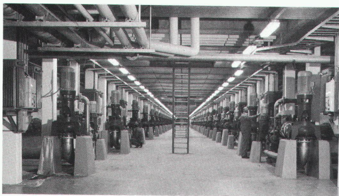
Installation d'épuration Lynetten, Copenhague, 115 pompes TURO.
