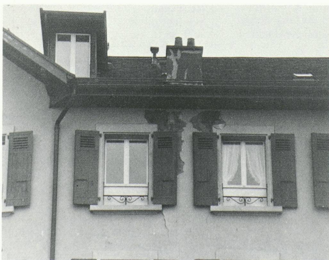
Fig. 1. - Dégâts à la façade, dus à la condensation dans le conduit de la cheminée.
