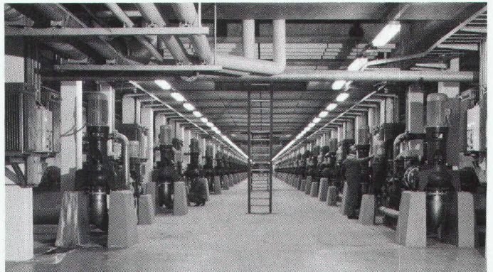
Installation d'épuration Lynetten, Copenhague, 115 pompes TURO.
