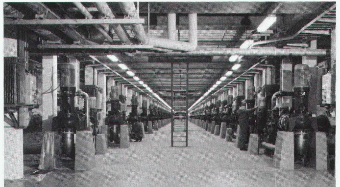
Installation d'épuration Lynetten, Copenhague, 115 pompes TURO.
