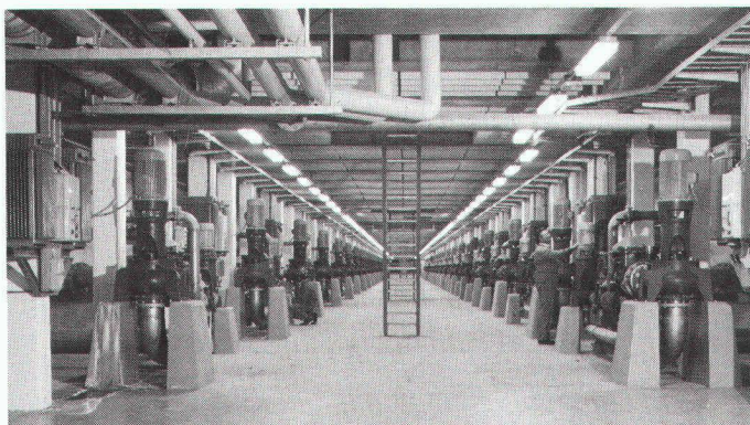
Installation d'épuration Lynetten, Copenhague, 115 pompes TURO.
