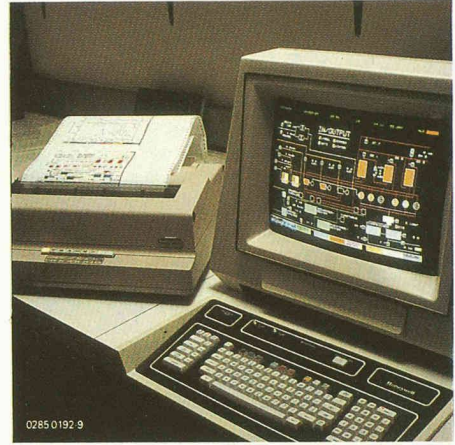
Fig. 9. — Poste de commande régissant la centrale énergétique, équipé d'un terminal couleur et d'un traceur.
