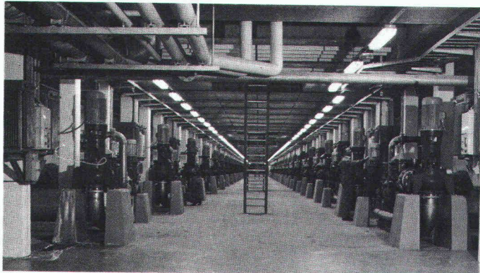
Installation d'épuration Lynetten, Copenhague, 115 pompes TURO.
