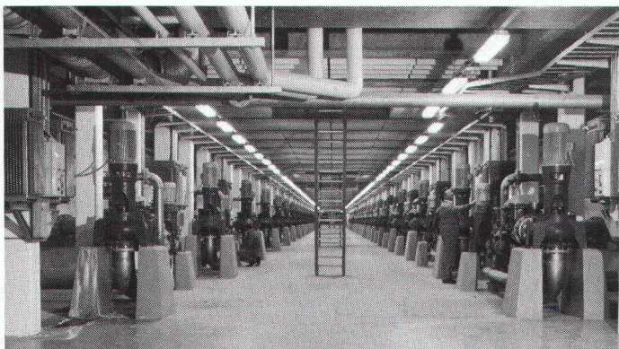
Installation d'épuration Lynetten, Copenhague, 115 pompes TURO.
