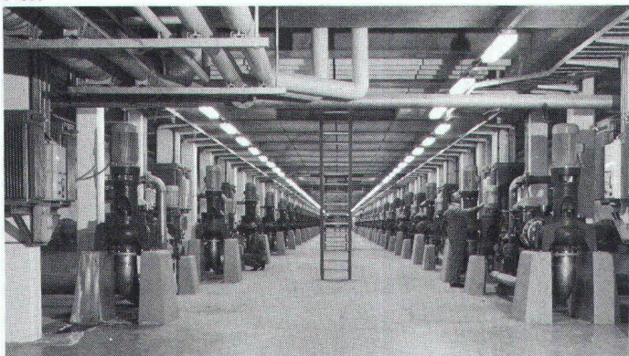
Installation d'épuration Lynetten, Copenhague, 115 pompes TURO.
