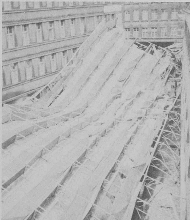
Echafaudage effondré à la suite d'une tempête
