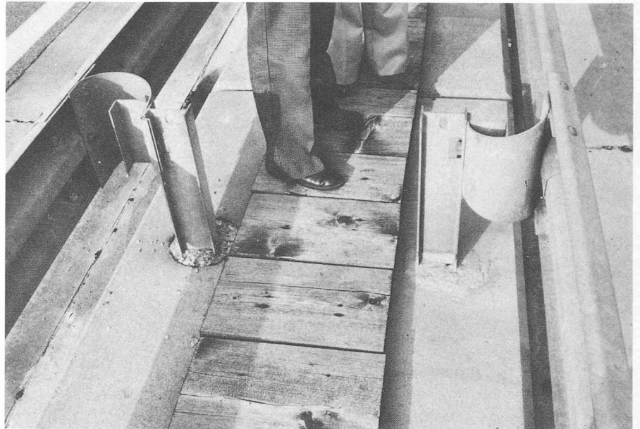
Fig. 17. — Les glissières de sécurité se trouvent au-dessus des bordures. Détail du poteau de droite: mise en service du pont en 1971. La protection du scellement du poteau fut posée en 1975, ce qui signifie qu'elle a été exposée au sel de déneigement durant 4 ans sans protection et durant 5 ans avec une protection. Exemple pris sur la N5 (photo 1980, protection Efkaprène).
