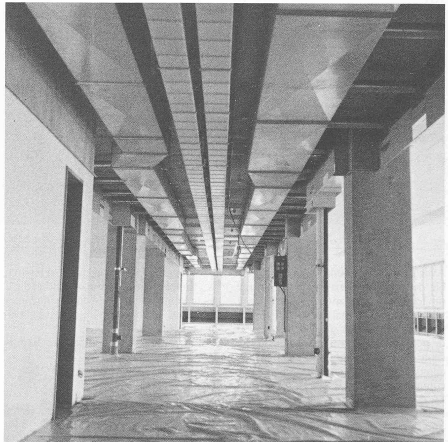
Fig. 21. — Canaux de distribution électrique et de ventilation dans faux plafonds des corridors.
