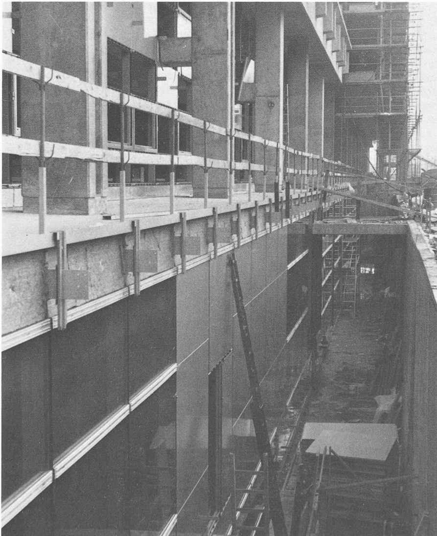
Fig. 8 — Vue en enfilade de la façade est du bâtiment d'exploitation. Détail du puits de lumière servant à l'éclairage naturel de l'étage inférieur.
