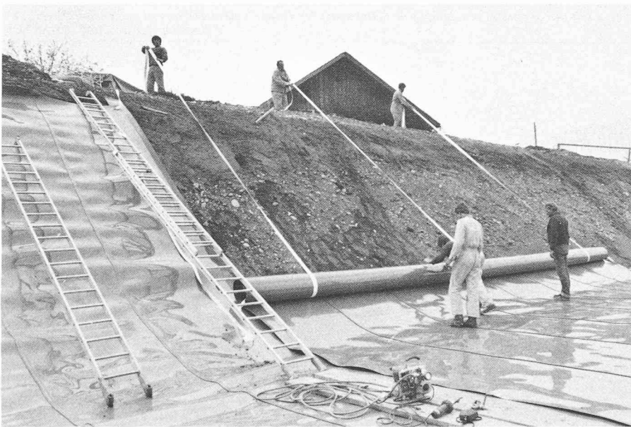
Fig. 8. — Pose et montage des feuilles d'étanchéité synthétiques en Sarnafil FP de 2 mm d'épaisseur. D'une largeur de 11,20 et d'une longueur allant jusqu'à 41,40 m, elles sont posées grâce aux rubans enroulés par l'usine. Après la pose, ces rubans ont servi en même temps à la fixation des feuilles d'étanchéité sur les talus. Les feuilles ont été posées en se superposant. (Photo: Sarna Kunststoff AG, Sarnen)
