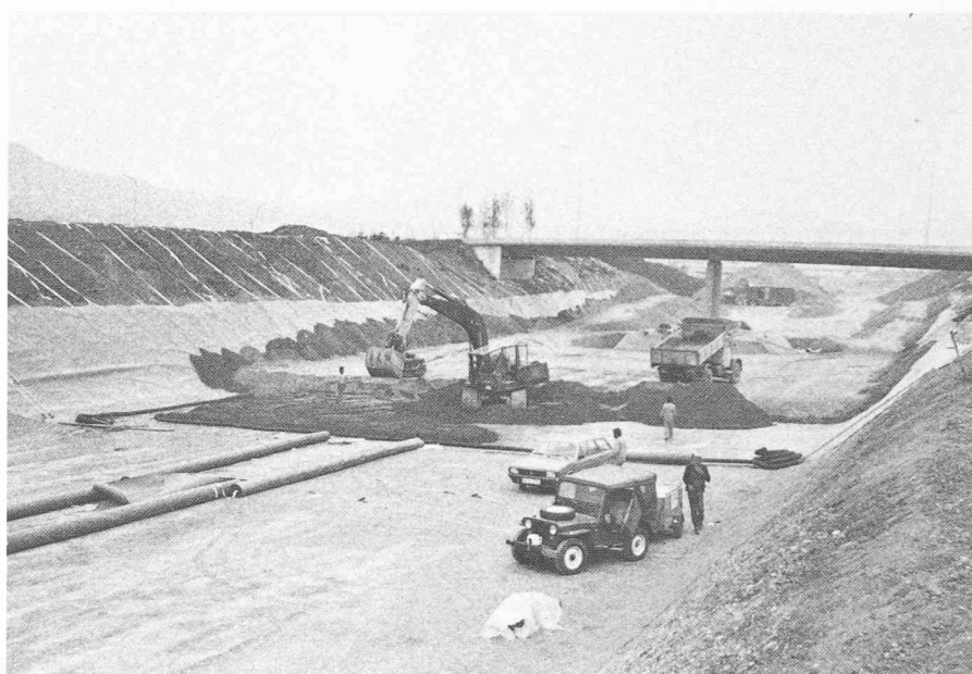
Fig. 5. — Au-dessus de la couche de sable, on a remblayé avec des matériaux d'excavation du tunnel jusqu'à la cote inférieure du corps formant chaussée. Grâce au bas positionnement de l'étanchéité on a pu éviter que celle-ci soit percée par des installations de toutes sortes (exception fondation du pont) de la chaussée.
