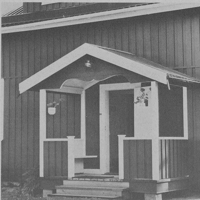
Fig. 1. — L'extérieur de cette maison vieille de 60 ans a été restauré grâce à un bardage en acier recouvert avec le film résistant aux intempéries de Du Pont «Tedlar» PVF, tout en préservant l'intégrité architecturale de cette construction typiquement suédoise en pans de bois.
