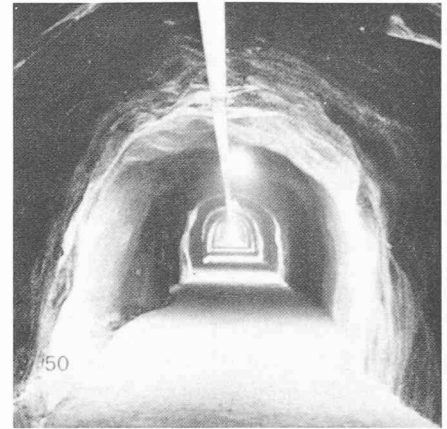
Fig. 8. — Vue à l'intérieur de la galerie de sécurité terminée avec l'éclairage définitif.
