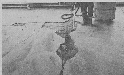
Chape ciment présentant de nombreuses fissures, trous, éffritement, etc.
