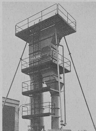
Installation pilote pour essais de décantation.
