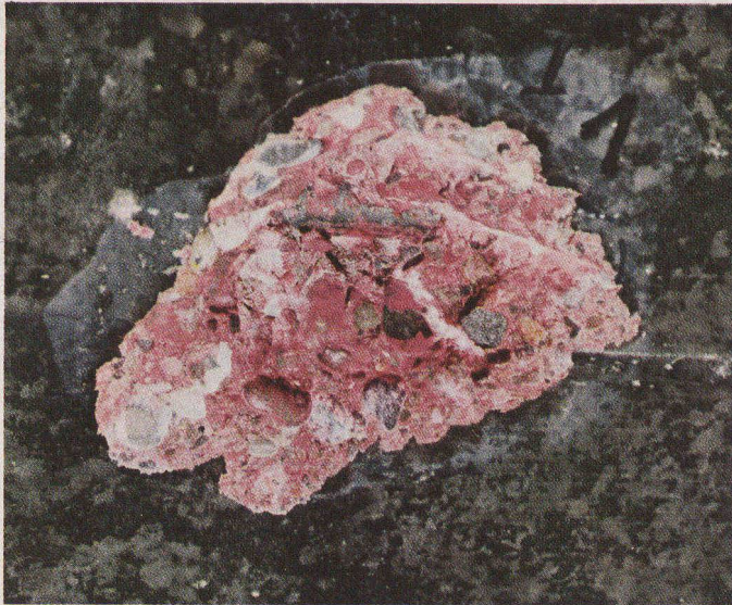
Pont A. — Aucune trace de carbonatation à l'âge de 42 ans ! La liaison béton-acier est parfaite.
