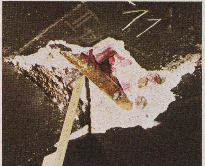
Pont C. — La différence d'aspect du fer de répartition dans la zone carbonatée (gauche) et la zone alcaline (droite) est significative. Dans quelques années, l'oxydation du fer portant fera éclater sa couverture en béton.
