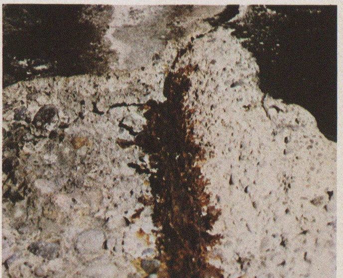
Pont C. — L'acier de diamètre 30 mm s'est entièrement transformé en oxyde de fer !
