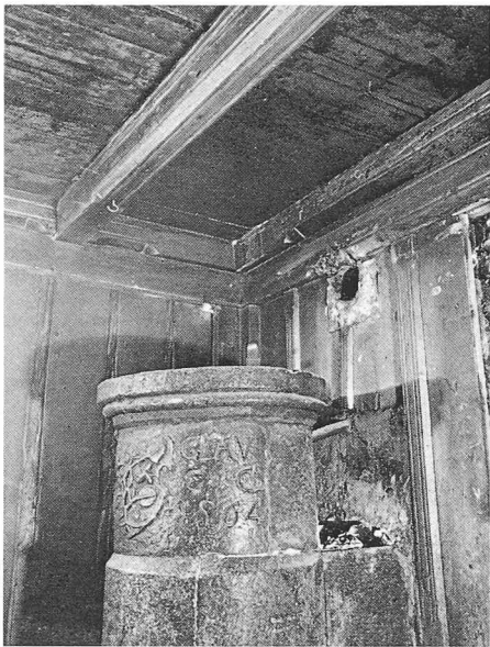
Fig. 7. — Maison de la Lombardie : chambre au fourneau ; détail avant la restauration.
