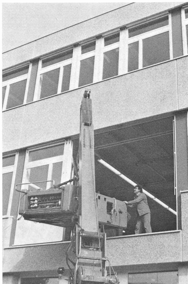
Eléments de façade ouvrants (deuxième niveau), permettant l'introduction des machines les plus encombrantes.
