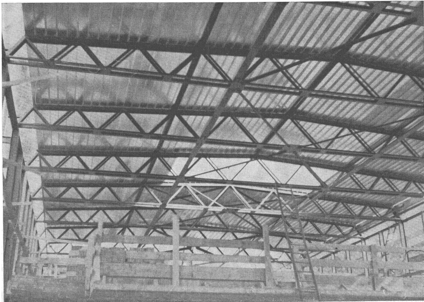
Toiture ACIÉROÏD sur le Bâtiment de l'Organisation Météorologique Mondiale, à Genève
