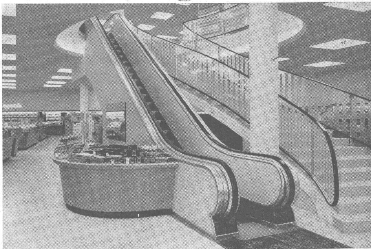
Escalier roulant Schlieren installé dans les Grands Magasins La Placette à Lausanne.
