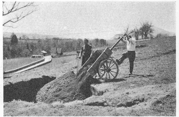
Fig. 9. — Remblayage des trous en surface. Remarquer la fissure limitant les affaissements au S.-W., à 10 m des murs de soutènement et exactement au-dessus de la limite du défilage.
