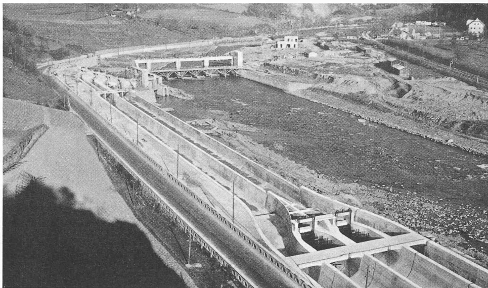
Fig. 9. — Vue sur l'entrée des dessableurs et des canaux latéraux, sur les diaphragmes, les canaux intermédiaires, avec, au fond, les dégraveurs, la prise d'eau et le barrage.
