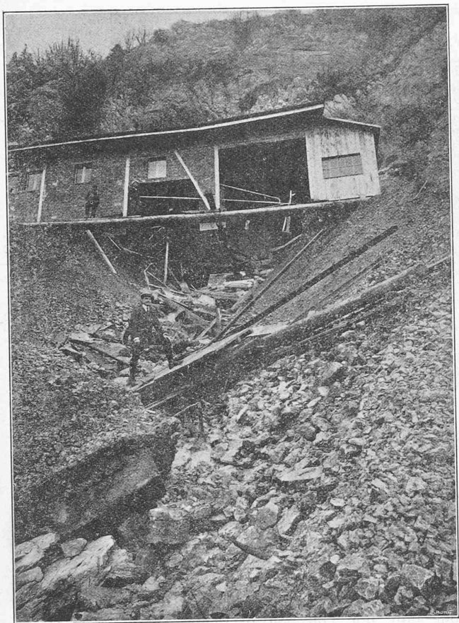
Fig. 24. — Le bâtiment des bains, après l'inondation.
