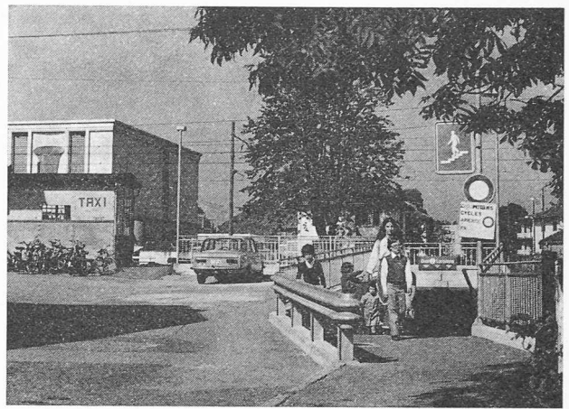
Fig. 89. — A Saint-Prex, les travaux de transformation sont en cours. Le passage à niveau de la gare, qui se situait à cet emplacement, a été supprimé en mars 1974. Il a été remplacé par un passage inférieur pour piétons, aménagé au même endroit, et par un passage inférieur routier, situé 200 m plus à l'est.
