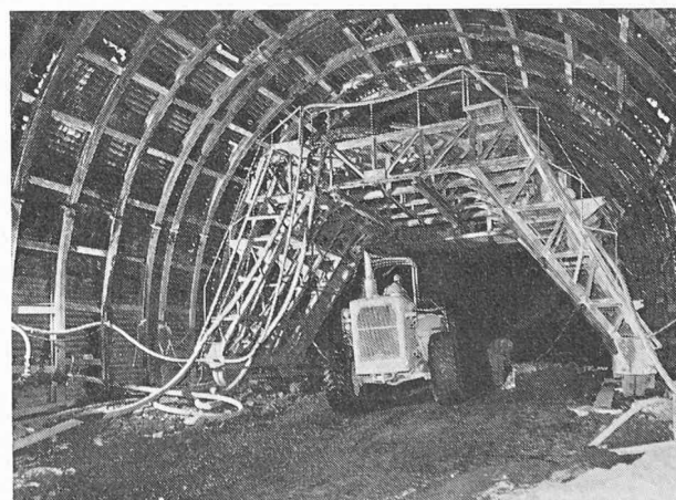
Fig. 9. — L'étayage métallique et le chariot destiné à la mise en place du béton d'étayage.
