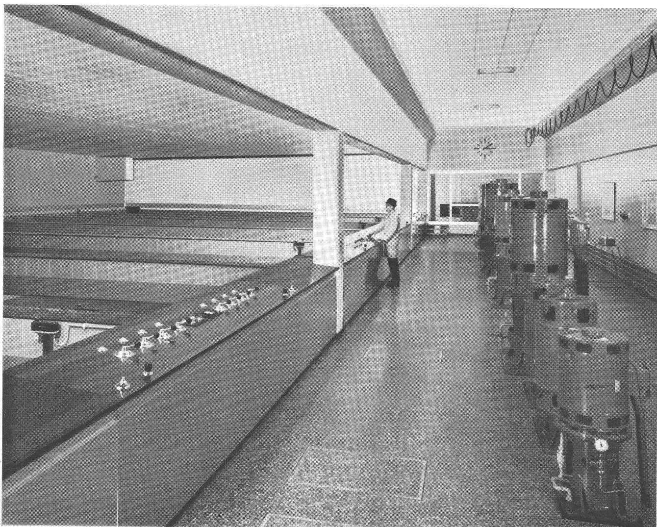
Station de filtres rapides «Champ-Bougin» de la ville de Neuchâtel ayant un débit de 1800 m 3 /h. A droite, les moteurs d'entraînement des pompes
